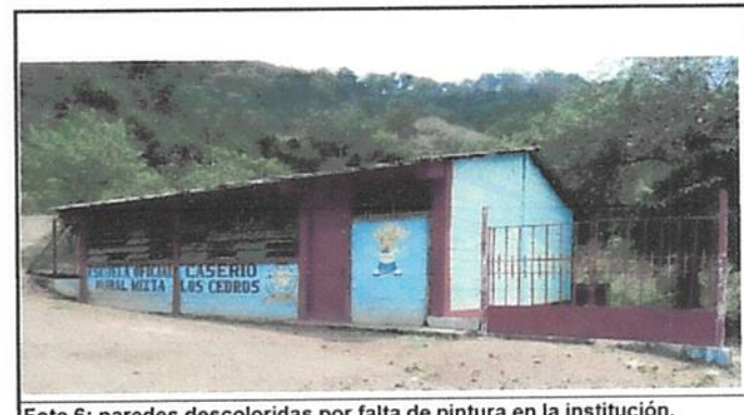
Foto 6: paredes descoloridas por falta de pintura en la institución.
