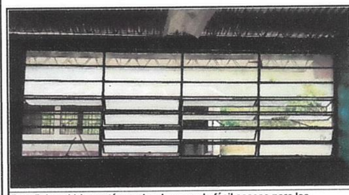
Foto 5: los vidrios están quebrados y es de fácil acceso para las personas dentro de las aulas u otros espacios privados.
