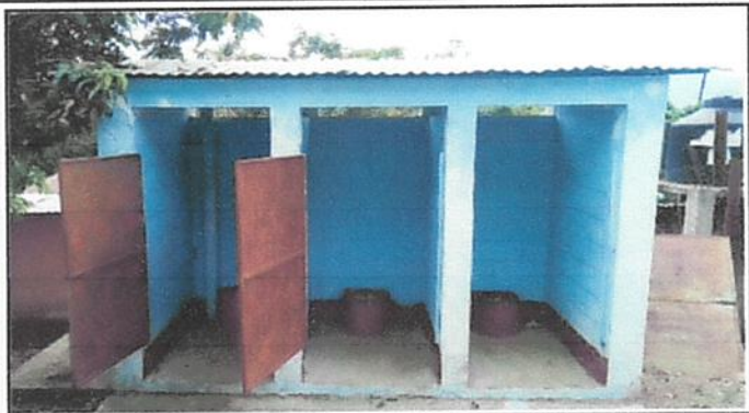
Foto 1: los sanitarios no son adecuados para el uso de los niños y las puertas están sin seguro.
